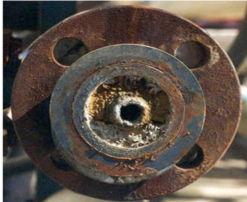
Figure 7: Corrosion of tubes (Kagel A., 2008).
