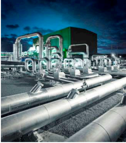
Steam Condensing Nga Awa Purua / Rotokawa 2010
